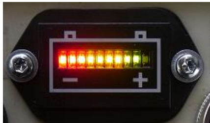
Anzeige des Ladevolumens des Batteriesystems
